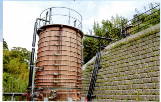
木製構造で更新した第一野中山貯湯槽
